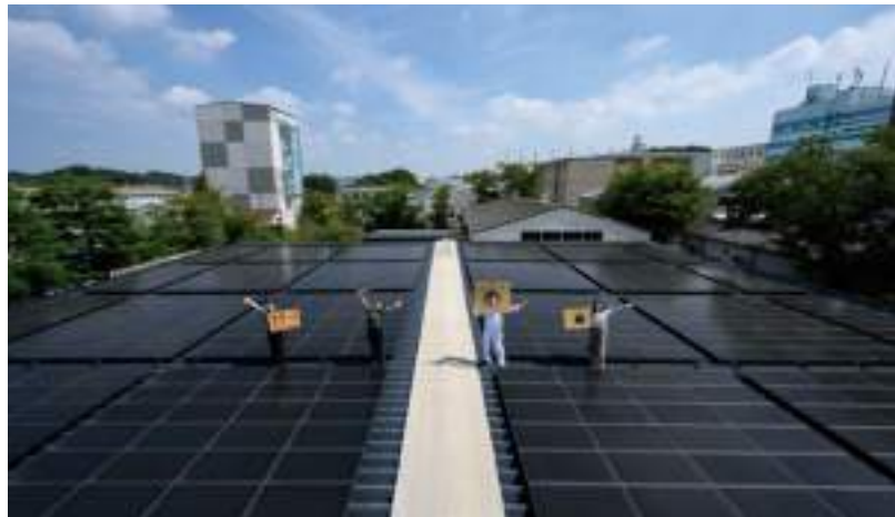
大川印刷の社屋に設置された太陽光発電パネル
